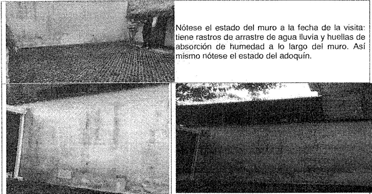
Foto No. 38 Humedad muro del patio
