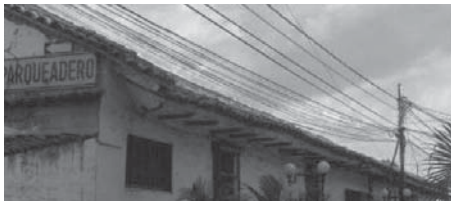
Δ Disposición exagerada, caótica y de baja altura de todo tipo de instalaciones, telefónicas, eléctricas, televisión, etc.
