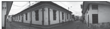
Imagen 15. Edificación colonial, antigua sede del Colegio José María Cabal, carrera 10 calle 7 esquina. Δ
