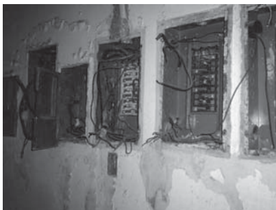
Vista de los tableros eléctricos pasillo acceso oriental
