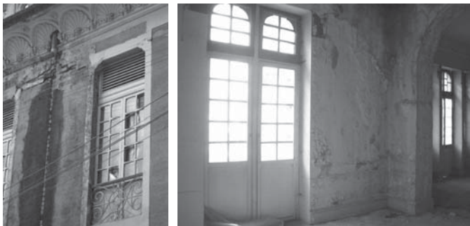
1. Fachada norte. Vista de humedad por bajantes ineficientes, deterioro de ornamentación desprendimiento de material de recubrimiento de fachada 2. Vista parcial antiguo tocador (2do piso). Humedad y desprendimiento de materiales capilaridad descendente. Deterioro en pisos y paredes.
