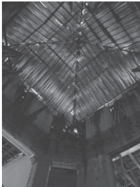
(Arriba) Estado de la cubierta y su estructura en la actualidad.
