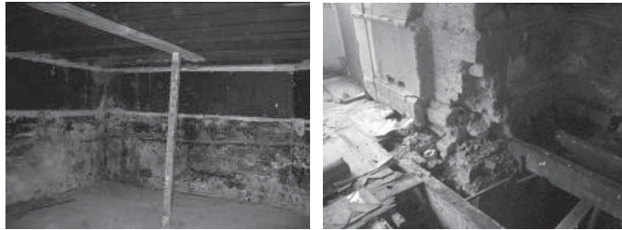
1. Vista de sótano. 2. Vista del comedor y salón de té. Colapso de entrepiso, columna y erosión en muro
