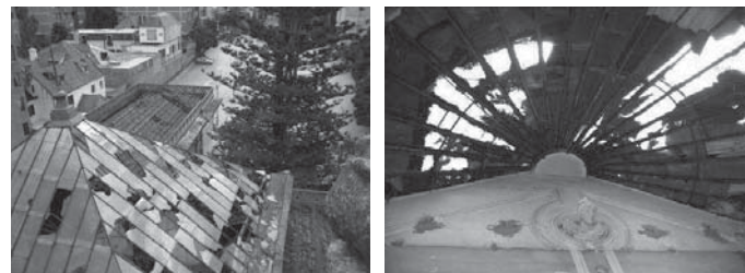
1. Vista colapso parcial de la marquesina central. Hoy con sobrecubierta en zinc 2. Colapso parcial marquesina salón de cartas
