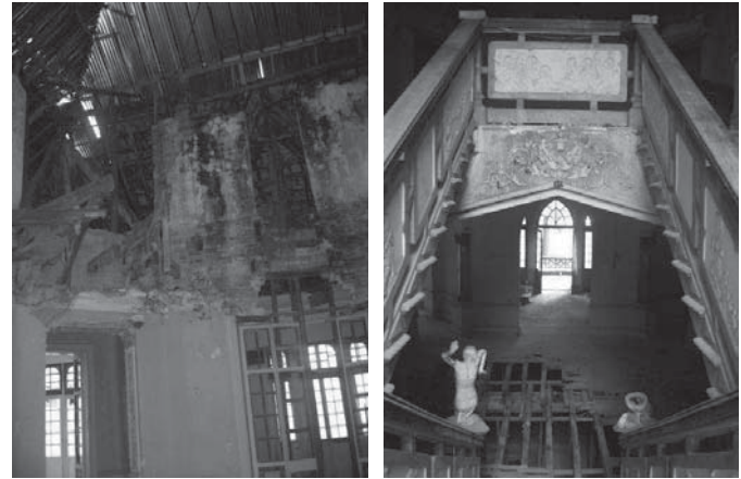
1. Vista de muros de carga costado norte 2. Vista vestíbulo central desde escalera
