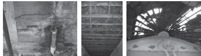
1. Humedad por capilaridad ascendente en acabados de fachada, erosión de ladrillo y flora parasitaria 2. estructura de cubierta zona habitaciones segundo piso 3. Deterioro de marquesina salón de cartas, filtraciones por lluvia
